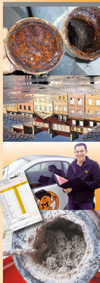
„Infarctus“ des canalisations à cause de la litière pour chats
